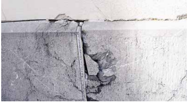
An etlichen Stellen ist der Sockel der Kirche beschädigt. An der Stelle auf dem Foto hat er sich bereits von der Mauer gelöst.
